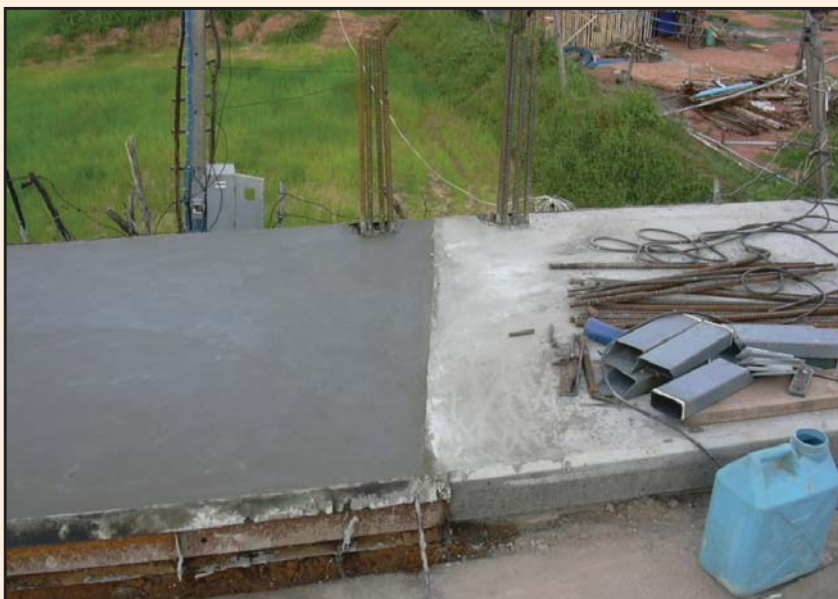
รูปที่ 4-22 แสดงรอยต่อระหว่างพื้นทางเท้าสะพาน
