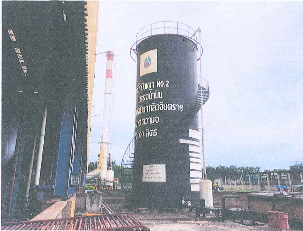
รายการที่ 3 ถังน้ำมันเตา
