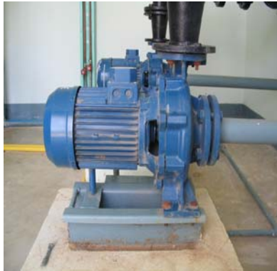
(2) โรงสูบน้ำดิบ
